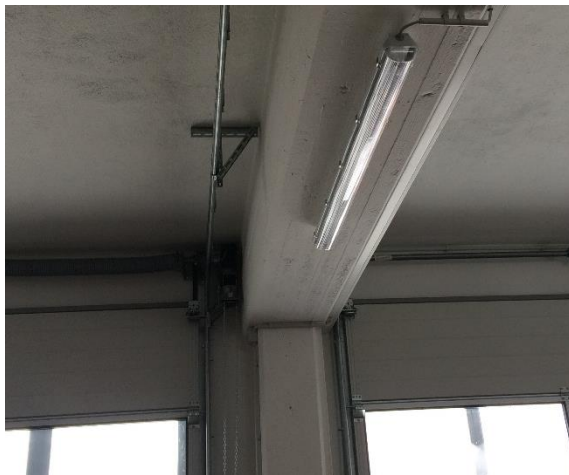
Neue LED-Beleuchtung im Bauhof
